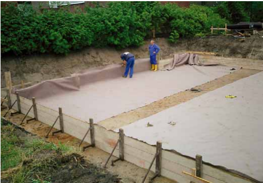
Die Abdichtung der Sohle: Zuerst wird in der trockenen Baugrube das ABG-Schutzfließ ausgelegt.
