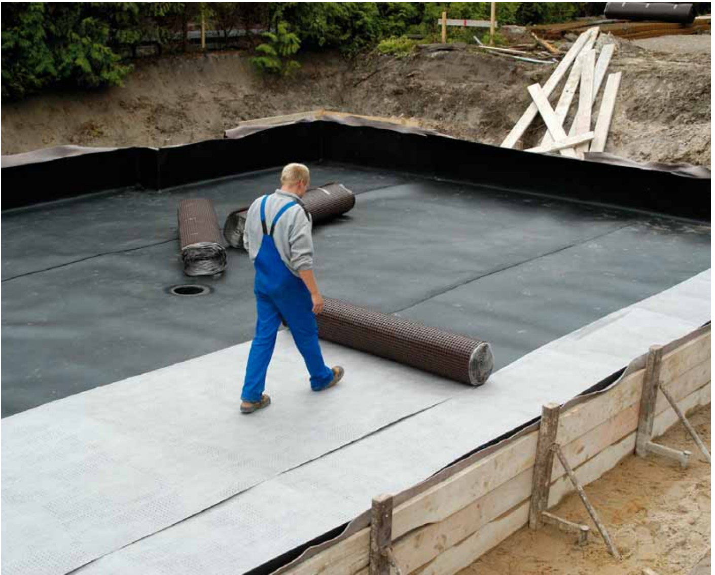
Dann folgt das Auslegen der ABG-Atmungsfixbahn. Entsprechend wird bei der Wandabdichtung verfahren. | Fotos: ABG
